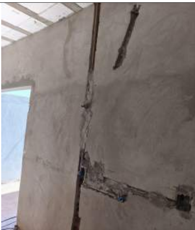
Imagem 04 – Tubulação de água fria
