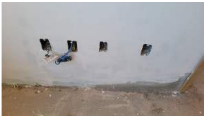
magem 05 – Instalação elétrica
