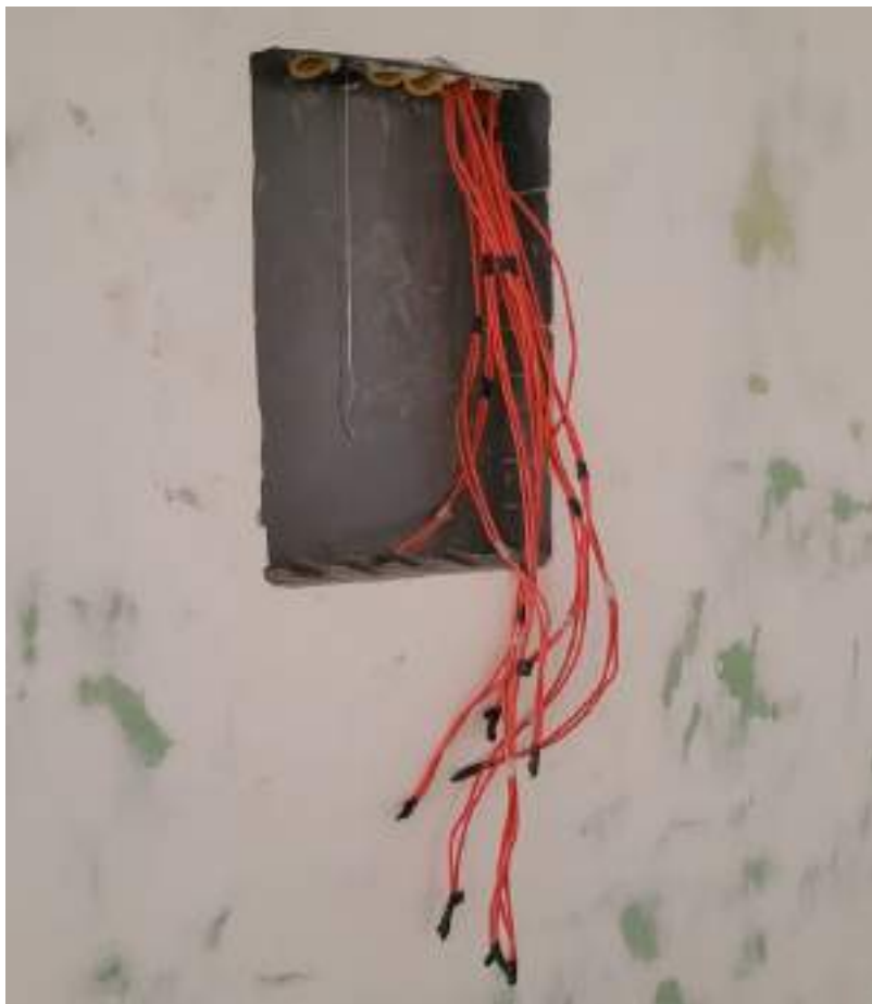
imagem 07 – Quadro de distribuição e tubo flexível
