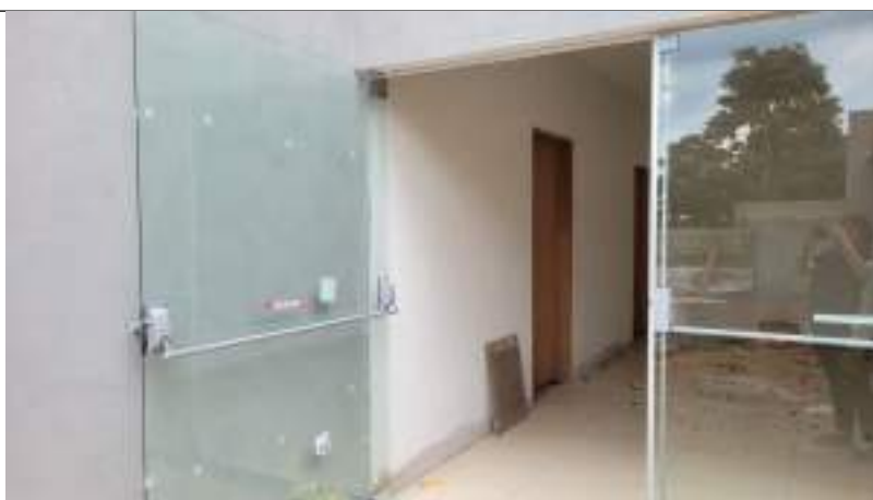
Imagem 08 – Porta de saída de emergencia
