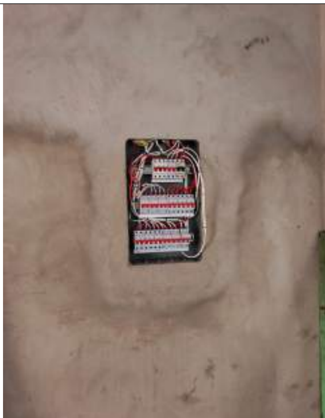
Imagem 08 – Quadro de energia
