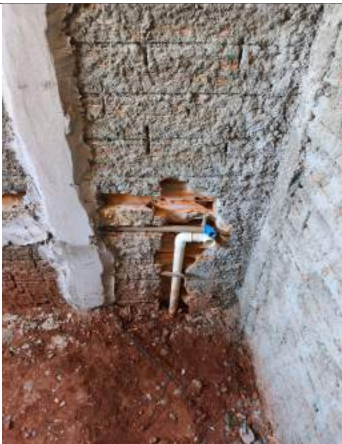
Imagem 03 – Tubulação de água fria e esgoto
