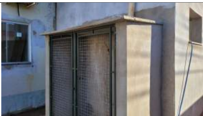
Imagem 05 – Casa de gás
