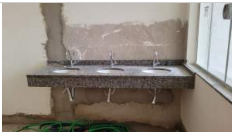
Imagem 03 – Cuba, Torneira, pedra, instalação hidráulica
