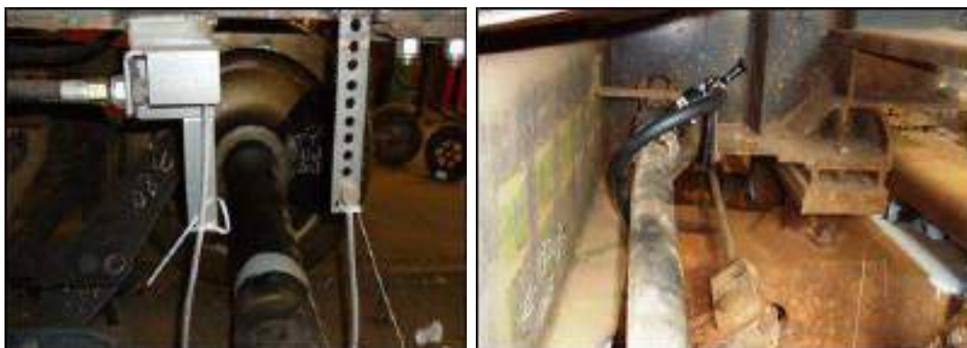
Figura 14 - DDV Detector de Descarrilamento de Vagão
