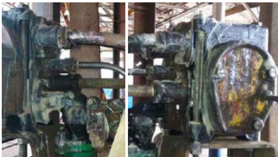
Figura 5 - Tubos do suporte de encanamentos
