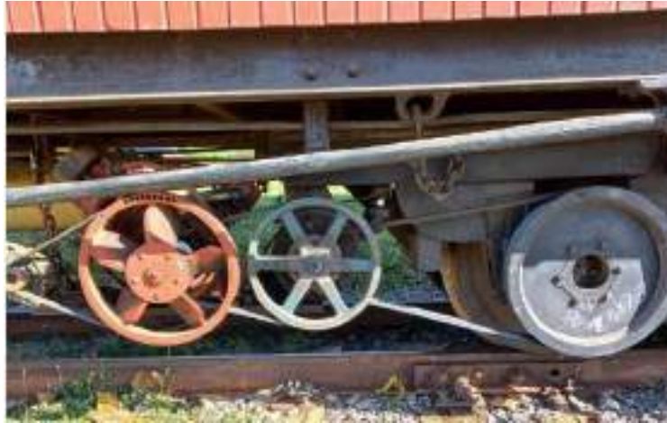
Compressor instalado no Vagão Passageiro
