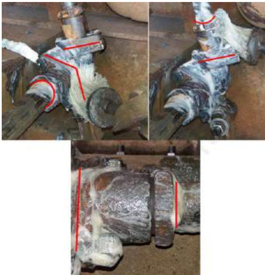
Figura 2 - Pontos de vazamento do T de ramal
