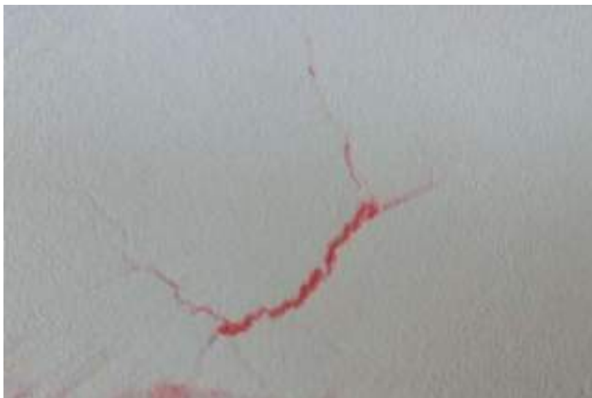
Figura 16 - Revelação da trinca.
