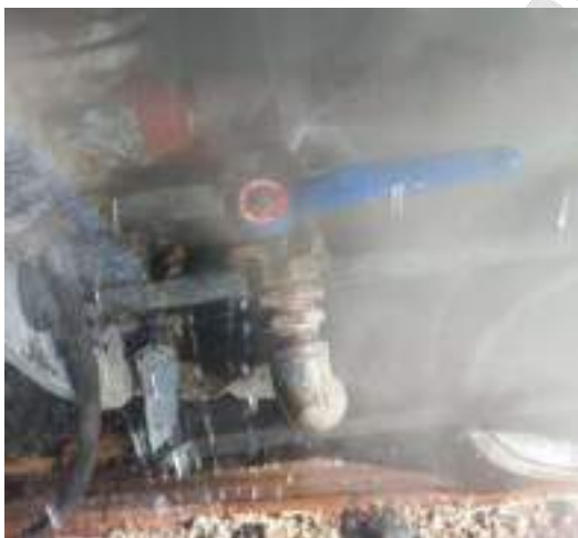
Torneira com Vazamento
